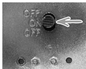
Interruptor protección del diafragma no activado. (Funcionamiento normal).
